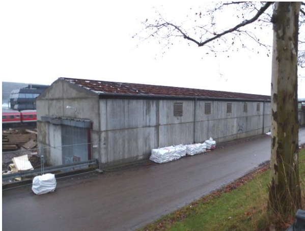
Abb. 4: Ältere, zerfallende, im Abbruch befindliche Lagerhalle
