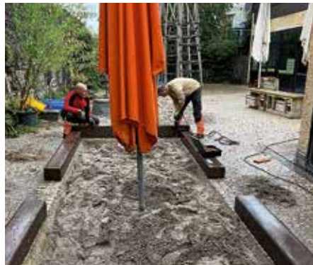
Unsere Bauhofmitarbeiter Martin Armbruster und Dennis Höllmüller (v.l.n.r.) beim Anbringen einer witterungsbeständigen Sandkasteneinfassung
